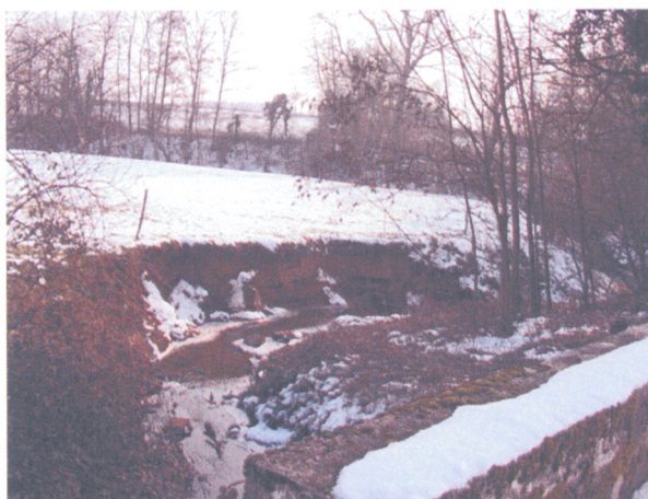
PHOTO 2 : Zone d'érosion à l'amont immédiat de la confluence avec le ruisseau de Chantemerle
